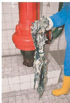
Sieht über aus und ist es auch: verflitzte Feuchttücher. Regelmäßig legen sie Abwassersysteme lahm.
