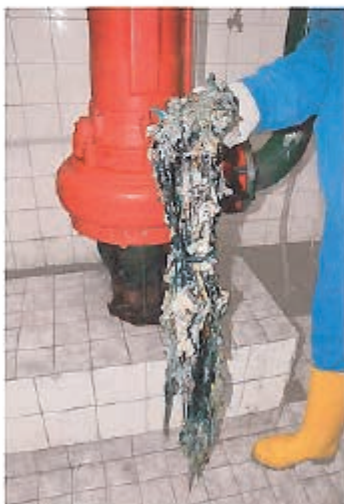
Steht über uns und ist es auch: verfilzte Feuchttücher. Regelmäßig legen sie Abwassersysteme lahm.
