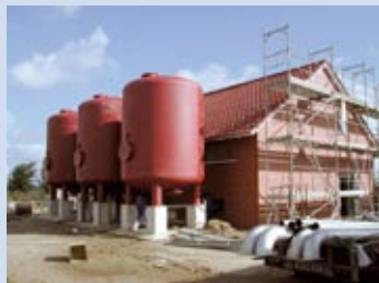
Das neue Wasserwerk Levenhagen
