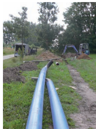
Trinkwasserverbindungsleitung Wasserwerk Levenhagen – Wackerow
