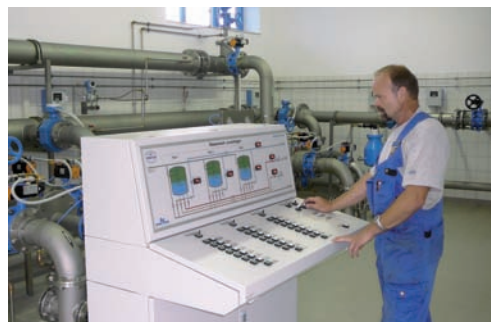
Leitstand des Wasserwerkes
