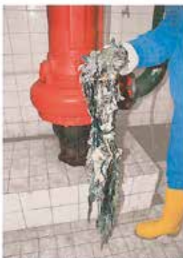
Sieht übel aus und ist es auch: verstopfte Feuchttücher. Regelmäßig legen sie Abwassersysteme lahm.
