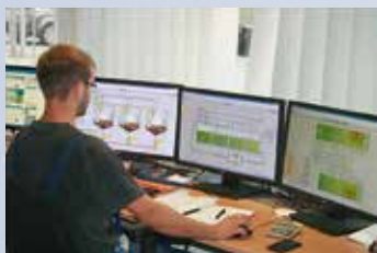
Leitstand Kläranlage Lubmin
